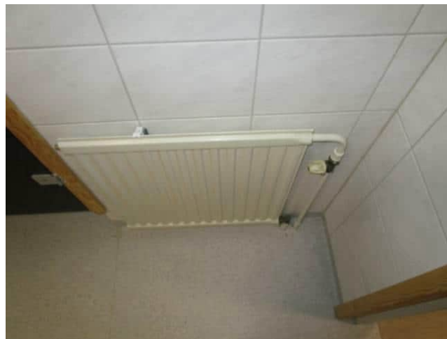
Kuva 6.42 Kylpyhuoneen lämmityspatteri ja patteriventtiili
