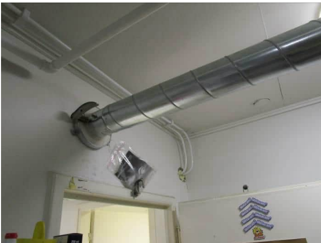
Kuva 6.63 Käytävän ilmanvaihdon päätelaite.
