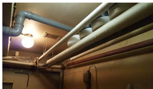
Kuva 58. Putkieristeistä otetuista näytteissä ei ollut asbestia, mutta eristeet suositellaan käsiteltäväksi asbestipitoisena.
