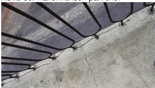
Kuva 32. Parvekkeessa halkeamat rataakiskojen kohdalla sekä parvekkeen etureunassa.
