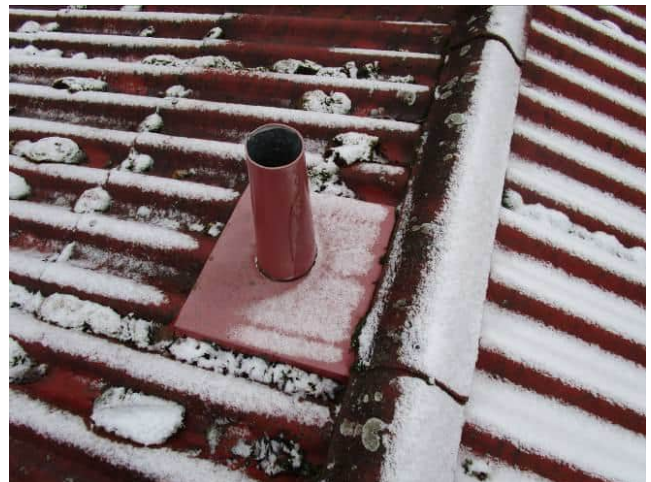
Kuva 6.56 Eristämätön tuuletusviemärin pää.
