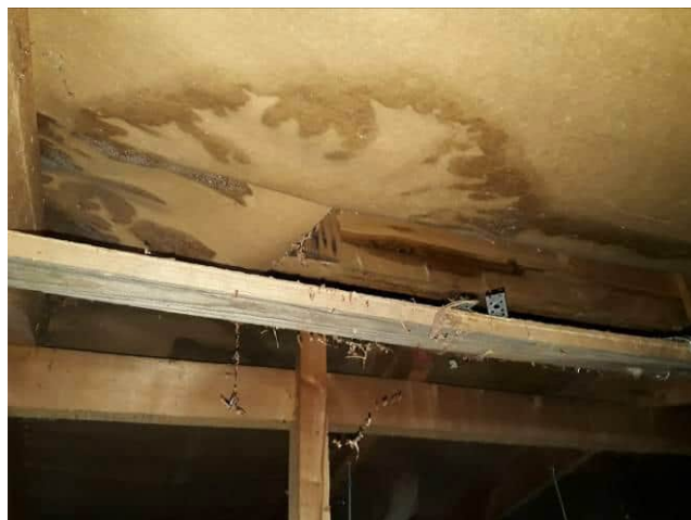
Kuva 6.30 Panssarialuskatteessa on näkyvissä vesijälkiä.
