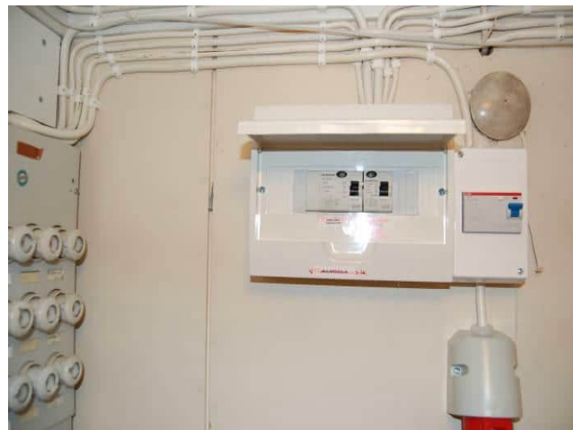
Kuva 6.67 Pääkeskukselle jälkikäteen lisätty lisäosa
