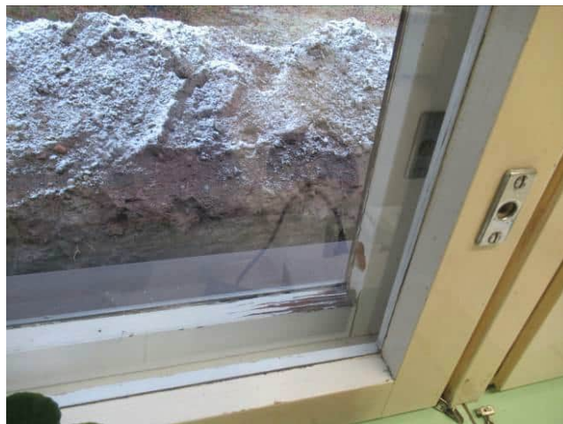
Kuva 6.23 Ikkunoissa on havaittavissa kosteuden aiheuttamia jälkiä.
