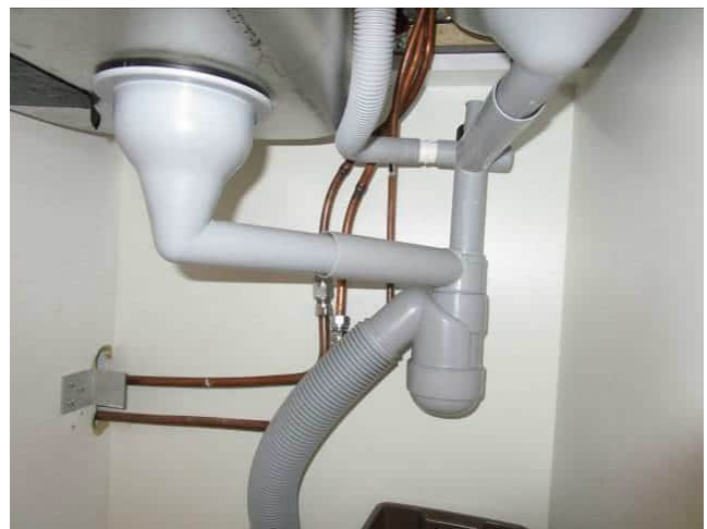
Kuva 6.69 Keittiön pesualtaan vesilukko
