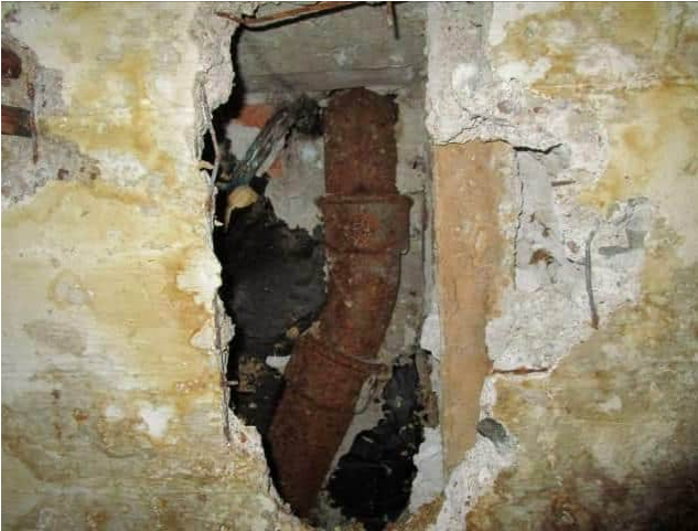
Kuva 6.66 Vaurioitunut jätevesiviemäri välipohjassa, joka vuotaa.
