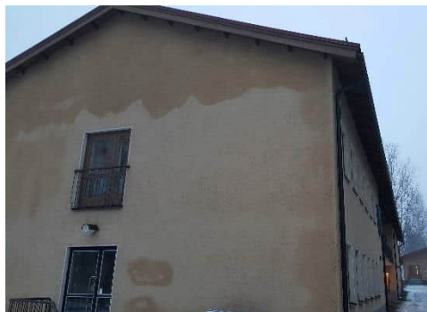
Kuva 35. Julkisivussa selkeästi näkyvissä lämpövuotoja.
