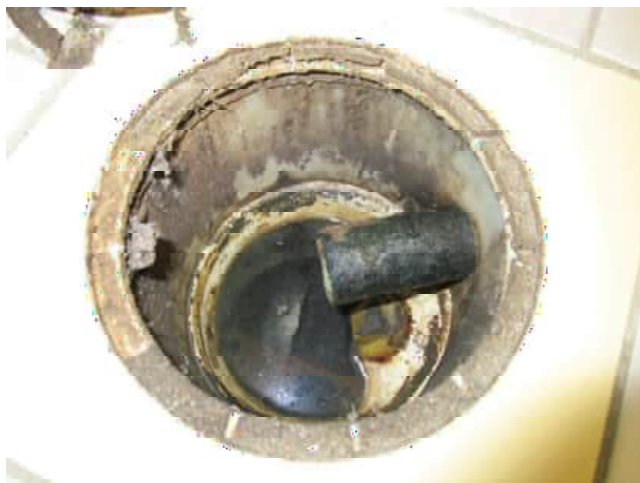
Kuva 6.47 Hieman likainen lattiakaivo
