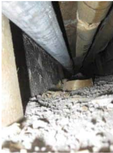
Kuva 6: Putkikanaalin avauspiste A: Kanaalin pohjalla rakennusjätettä
