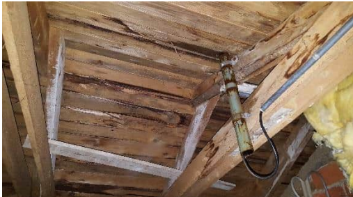
Kuva 24. Läpiviennin kohdalla ollut vesivuotoa.
