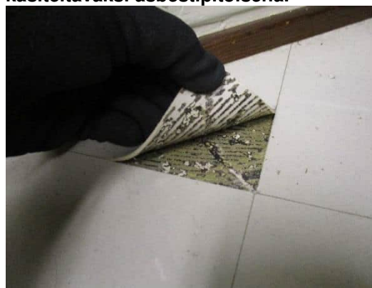
Kuva 56. Lattian musta liima sisältää asbestia.
