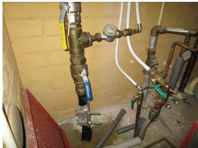
Kuva 6.44 Tonttivesijohto oli hyvässä kunnossa
