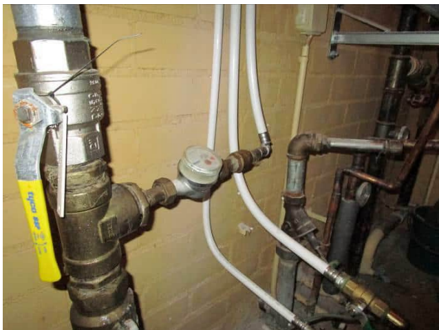
Kuva 6.43 Päävesimittari ja sulkuventtiilit varastuhuoneessa
