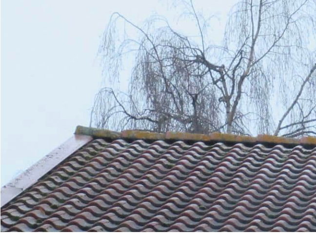
Kuva 6.33 Tiilissä on havaittavissa jonkun verran sammaloitumista.
