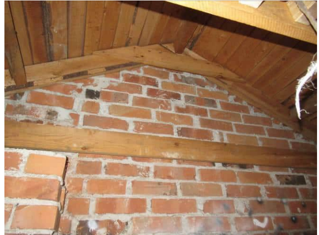
Kuva 6.31 Päätykolmioissa ei ole tuuletusaukkoja.
