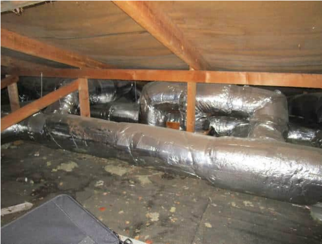
Kuva 6.53 Siistiä lämmöneristystä alumiinipinnoituksella
