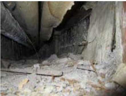
Kuva 9: Putkikanaalin avauspiste B, wc:n suuntaan kuvattuna. Kanaalin pohjalla rakennusjätettä
