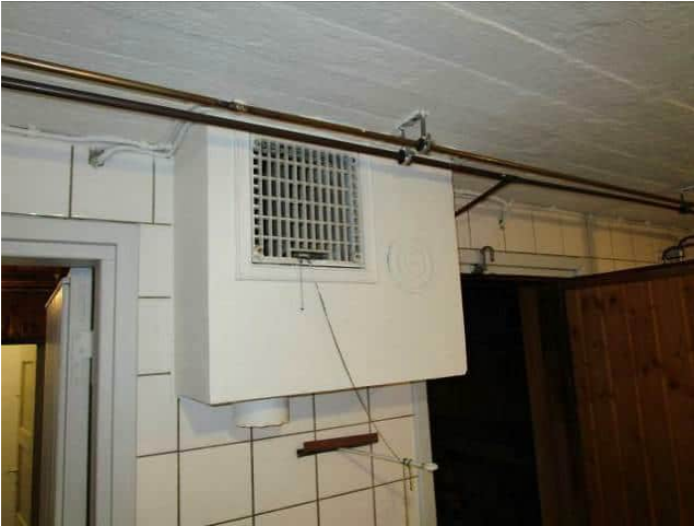
Kuva 6.74 Alkuperäinen poistoilmaventtiili hormiin asennettuna.
