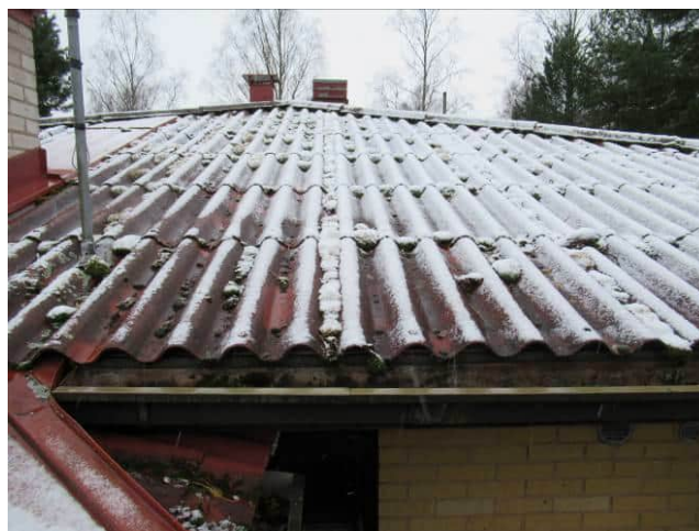
Kuva 6.35 Tiilikate on sammaloitunut.
