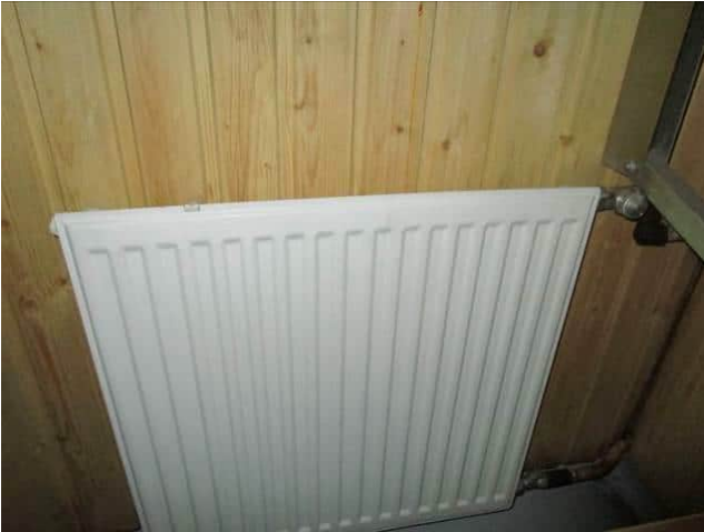
Kuva 6.58 Hyväkuntoinen patteri sekä käsinsäädettävä patteriventtiili
