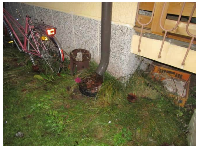
Kuva 6.2 Takapihan puolella kattovedet ohjataan sadevesikaivoon.
