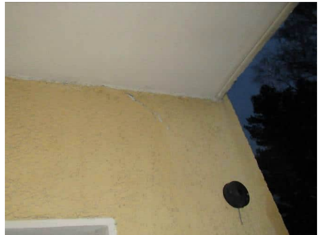
Kuva 6.19 parvekkeen seinässä vaurioita rappauspinnassa.
