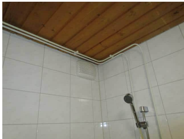
Kuva 6.46 Pinta-asennettua alkuperäistä kupariputkea saunatilassa
