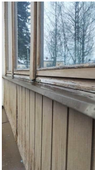
Kuva 20. Lounasjulkisivun ikkunan pellitykset kaatoivat sisäänpäin.
