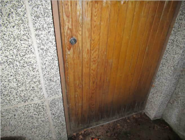
Kuva 6.23 Kellarin oven alareuna on vaurioitunut.
