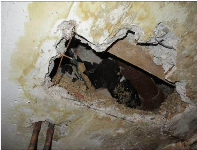
Kuva 6.40 Viemäriputki vuotaa vaurioittaen ainakin välipohjan eristeitä.
