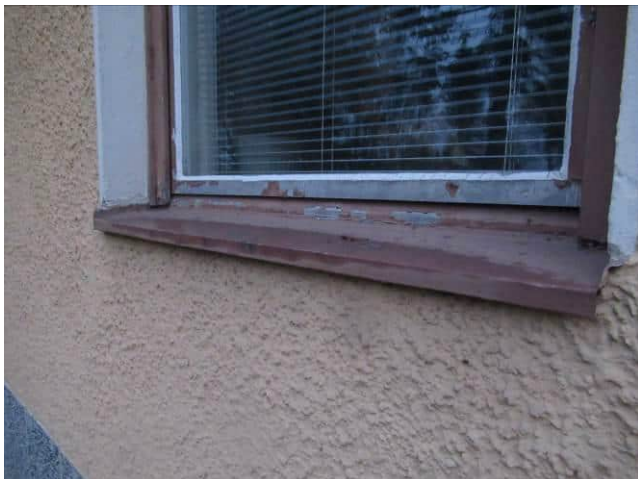
Kuva 6.22 Ikkunapellitysten kaato on paikoin riittämätön.
