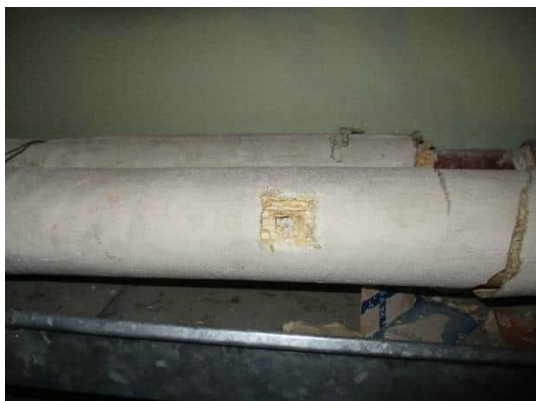
Kuva 53. Näyte putkieristeestä (ASB6), ei sisällä asbestia. Suositellaan kuitenkin käsiteltäväksi asbestipitoisena.
