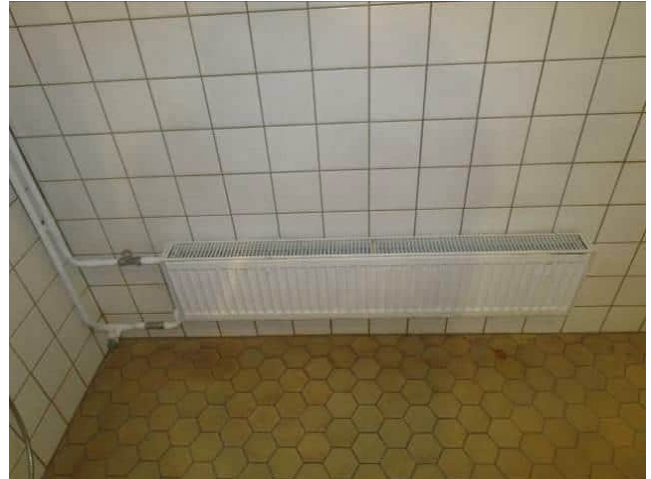
Kuva 6.59 Saunatiloissa oleva hyväkuntoinen lämmityspatteri
