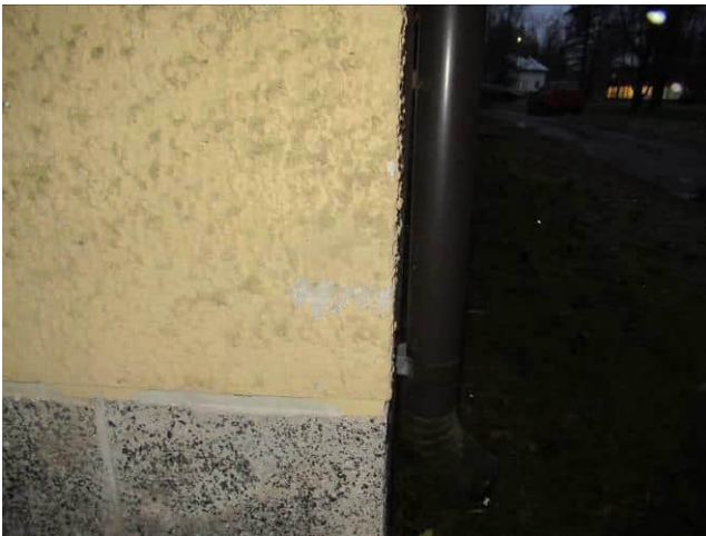
Kuva 6.17 Vaurioita rappauspinnassa rakennuksen nurkassa.
