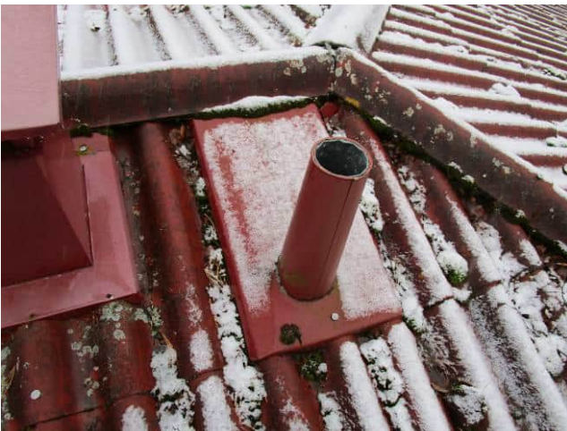
Kuva 6.55 Eristämätön tuuletusviemärin pää vesikatolla.
