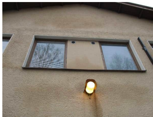
Kuva 60. Näyte julkisivurappauksesta (ASB10), sisältää asbestia. Eteläpäädyn yläkerran ikkunoiden välissä oleva levy on asbestipitoinen.
