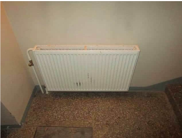
Kuva 6.60 Käytävän hyväkuntoinen lämmityspatteri
