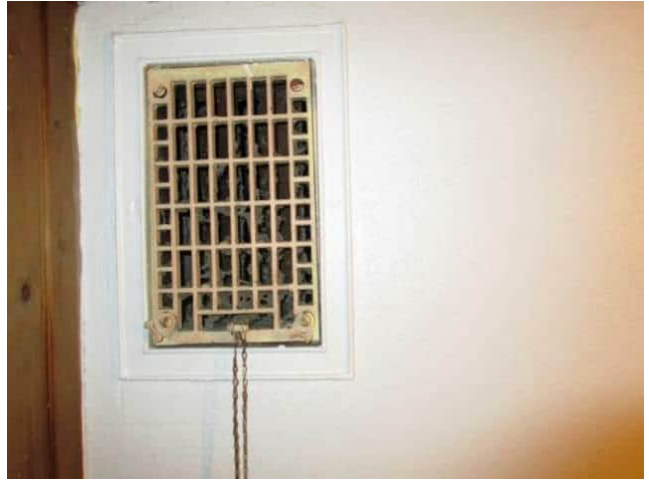
Kuva 6.75 Alkuperäinen poistoilmaventtiili hormiin asennettuna
