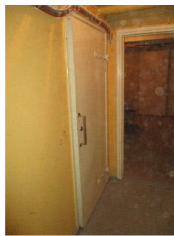
Kuva 69. Kellarin palo-ovet sisältävät asbestia.
