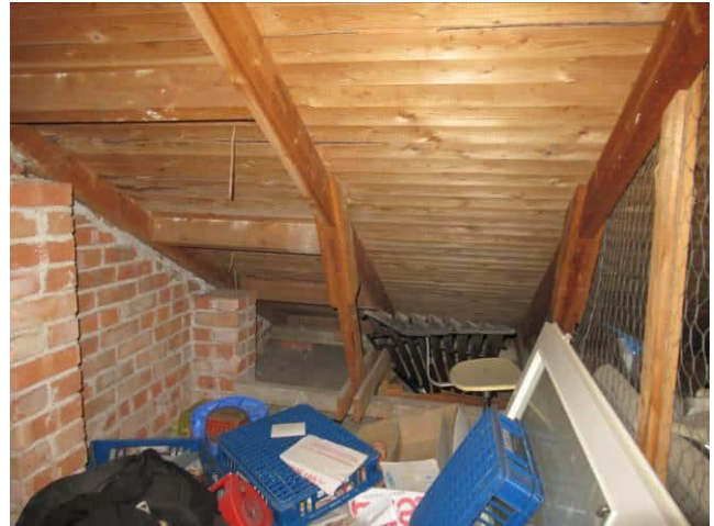
Kuva 6.32 Yläpohjatilassa säilytettävät tavarat aiheuttavat paloturvallisuusriskin.
