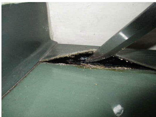
Kuva 61. Portaiden maton alla asbestipitoinen musta liima.
