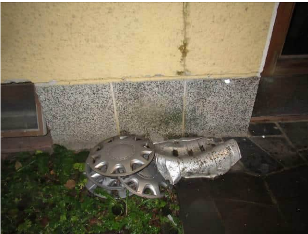
Kuva 6.5 Pääoven katokselta tulevat vedet kaste- levat rakennuksen seinää ja betonilaattaa.
