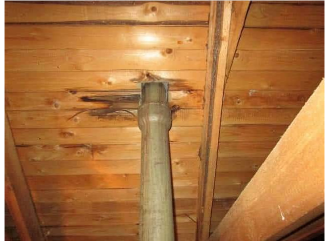
Kuva 6.67 Eristämätön tuuletusviemäri ullakolla
