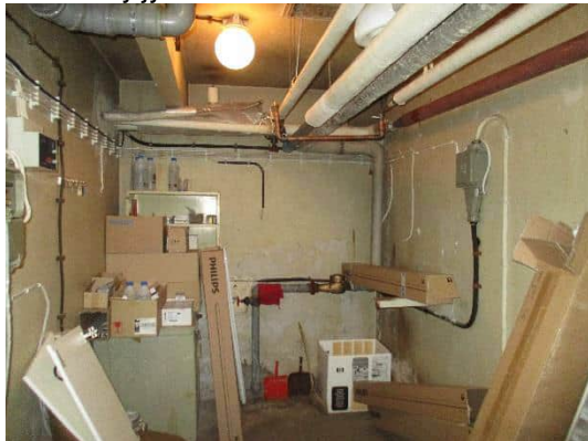
Kuva 83. Seinä- ja kattomaali sisältää sinkkiä (RM1).
