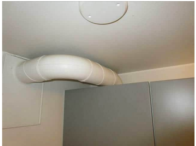
Kuva 6.77 Liesituuletin on kytketty hormiin ilmanvaihtokanavalla
