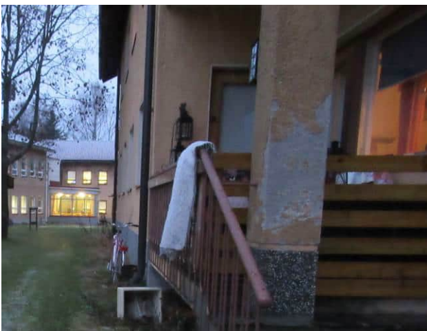
Kuva 6.18 Parvekkeen pilarin rappaus on vaurioitunut.
