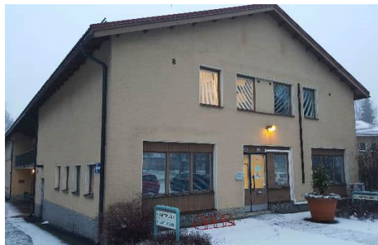
Kuva 36. Julkisivussa näkyvillä lämpövuotoja.
