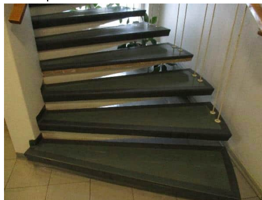
Kuva 62. Portaiden maton alla asbestipitoinen musta liima.
