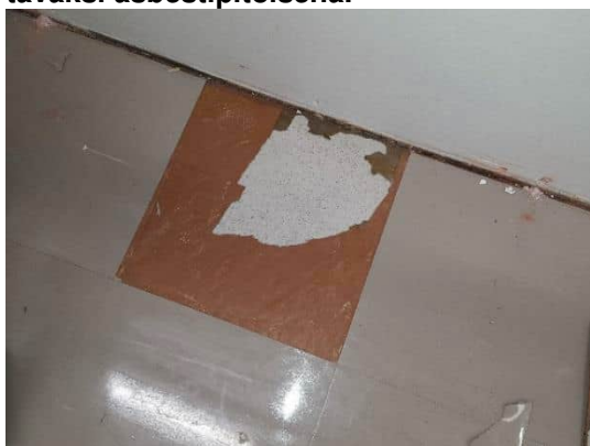
Kuva 55. Linoleumilattian alla vanha asbestipitoinen Finnflex-laatta. Liima ei ole asbestipitoista.
