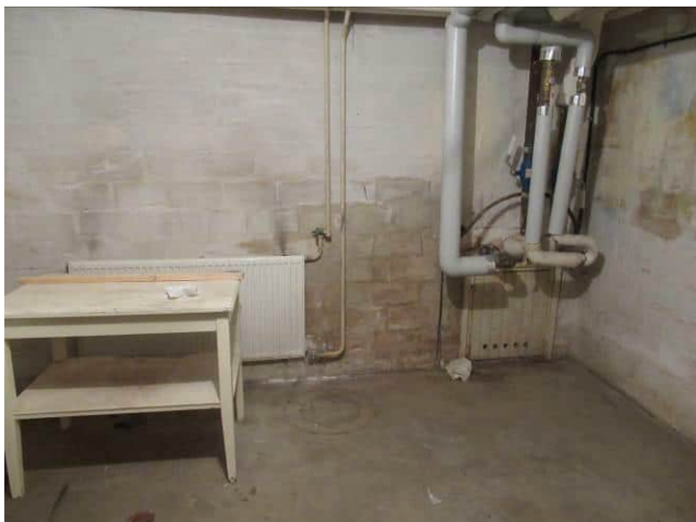
Kuva 6.16 Kellarin seinissä on havaittavissa viitteitä kosteudesta.
