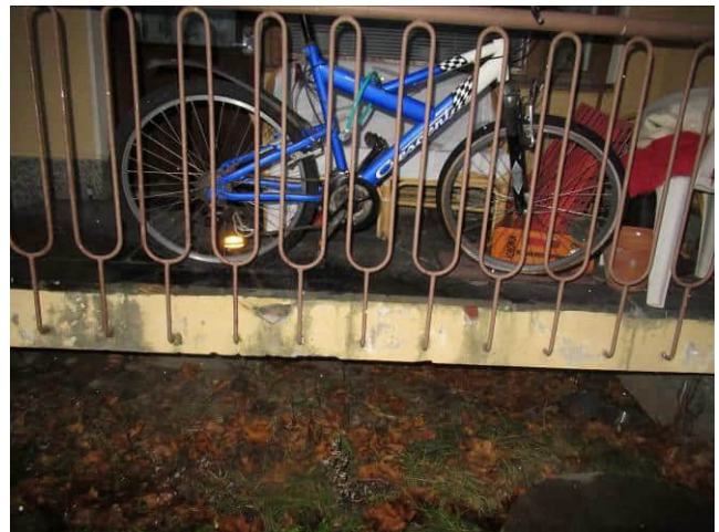
Kuva 6.25 Parvekelaatan etureuna on rapautunut.
