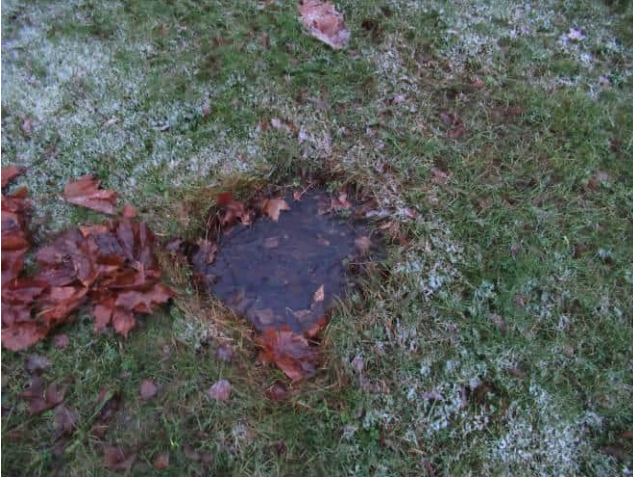
Kuva 6.3 Todennäköisesti salaojien tarkastuskai- vo.
