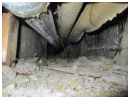
Kuva 8: Putkikanaalin avauspiste B, wc:n suuntaan kuvattuna. Kanaalin pohjalla rakennusjätettä
