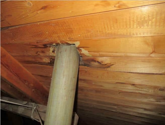
Kuva 6.29 Läpiviennin kohdalla vesijälkiä.
