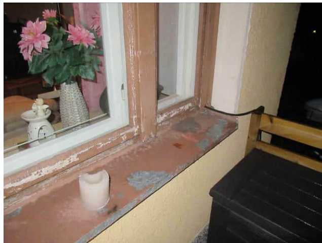
Kuva 6.21 Ikkunapellitykset ja ulomman ikkunan puitteet huonokuntoisia
