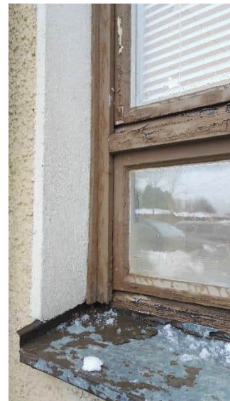
Kuva 21. Maalin hilseilyä ikkunoissa ja pellityksissä.
